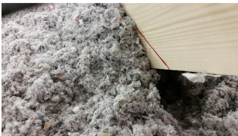
Kuva L2.3. Kuva painumaonkalosta vinosauvan alla, joissa eristekerrokseen on mekaanisesti tehty 20 % painuma. Eriste on painunut muualla normaalitilanteen mittausten aikana n. 1 %.
